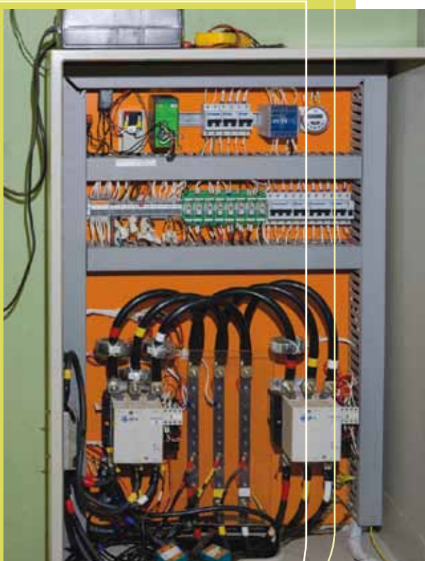
Painel de comando para ligação da geração distribuída à rede interligada da Copel.
